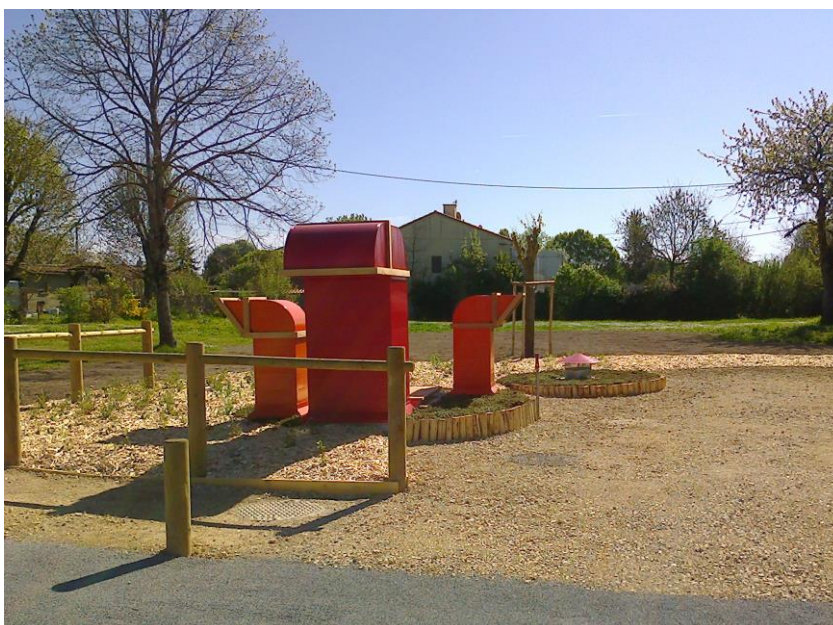
Figure 3 : poste Refoulement Amuré
