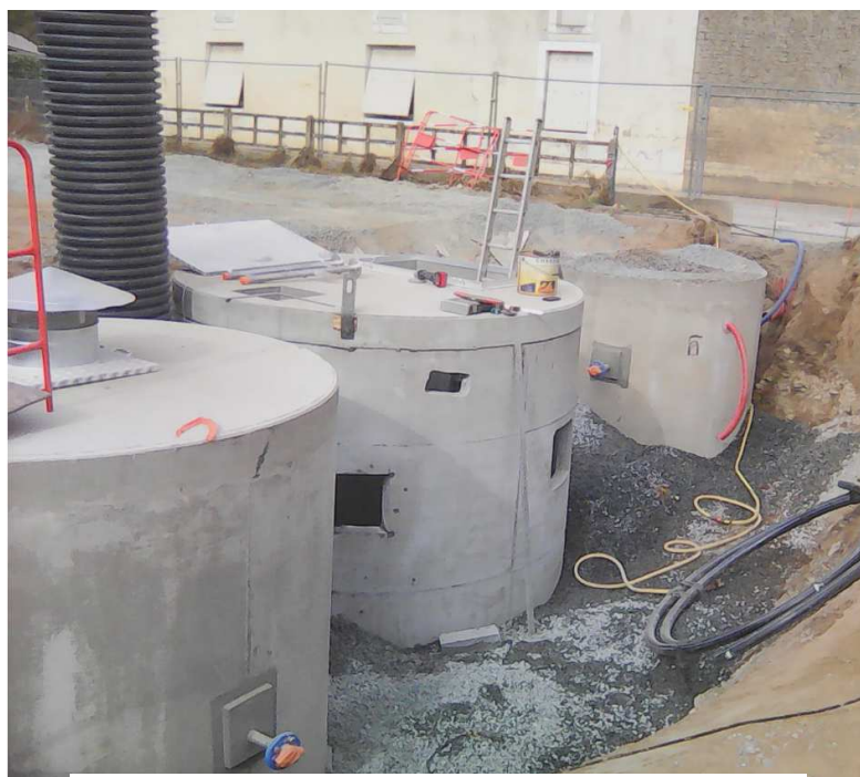
Figure 4 : Poste de refoulement Villiers en Plaine
